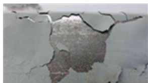
Производственный объект с дефектом «ЛКП»
